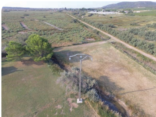
Le réseau électrique vu d'un drone
