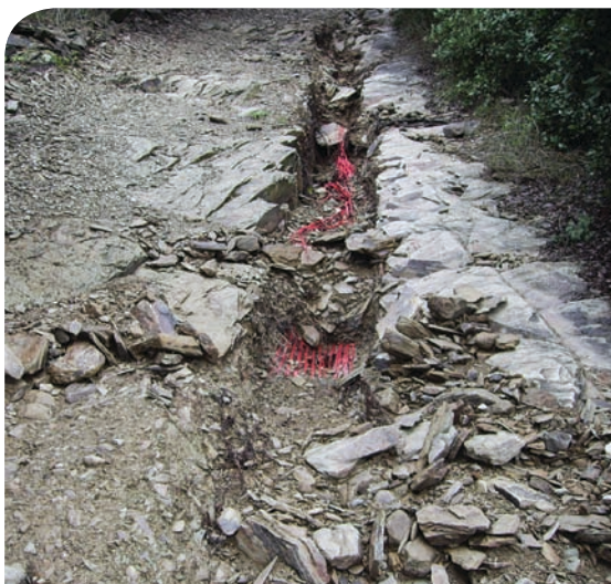
Photo de réseau souterrain prise après les inondations de l'ouest héraultais, octobre 2018
